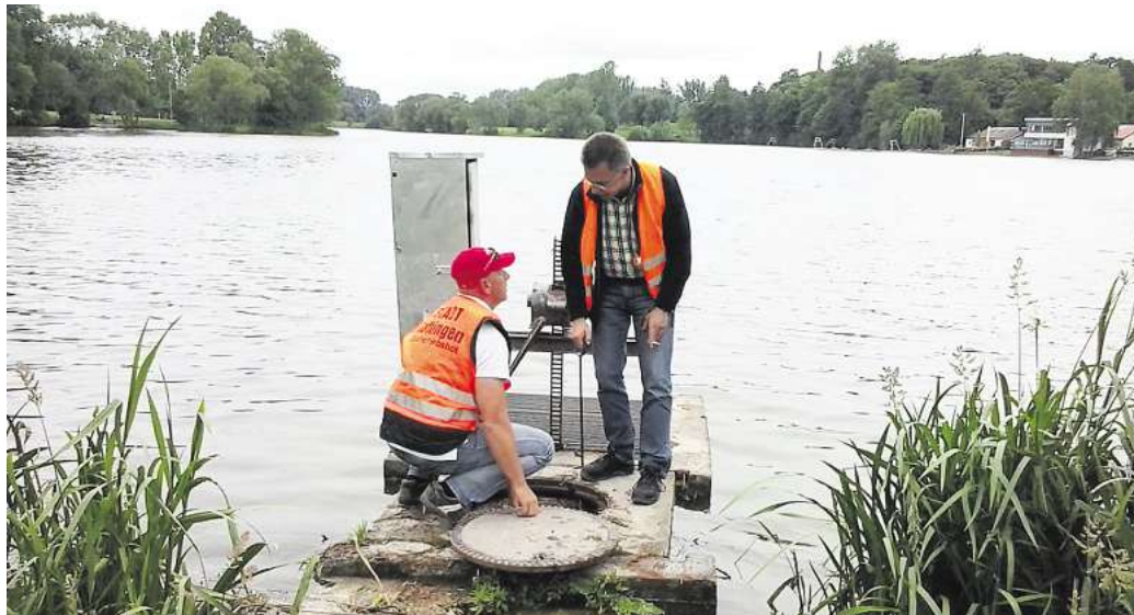
Gefahr erkannt: Mitarbeiter des Baubetriebshofes versuchen, den Abfluss zu reparieren.
